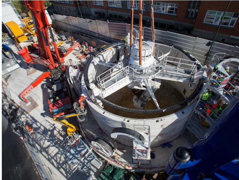
Fig 10. Vue générale de l'installation
