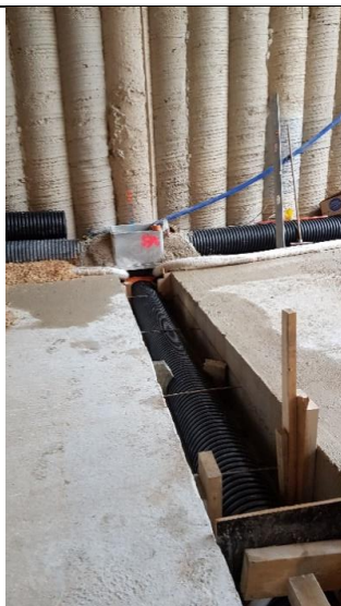
Dispositif de relevage des eaux de pluie
