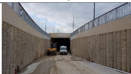
Trémie de sortie depuis la chaussée – noter les venues d'eaux aux intersections de pieux
